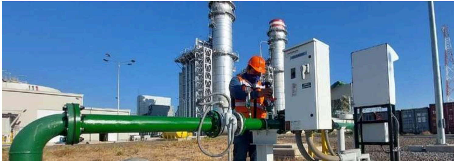
Imagen demostrativa de una instalación
